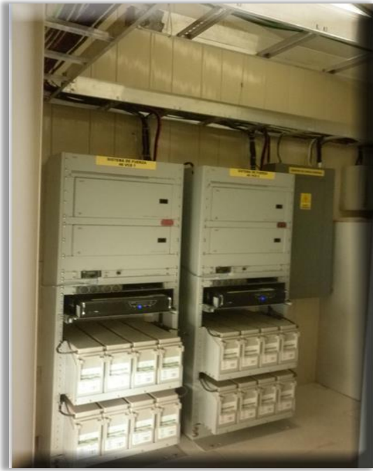
Escalerilla para fuerza en CD y/o CA
