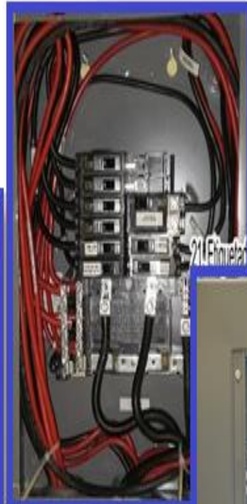
8. Distribución de centro de carga.
