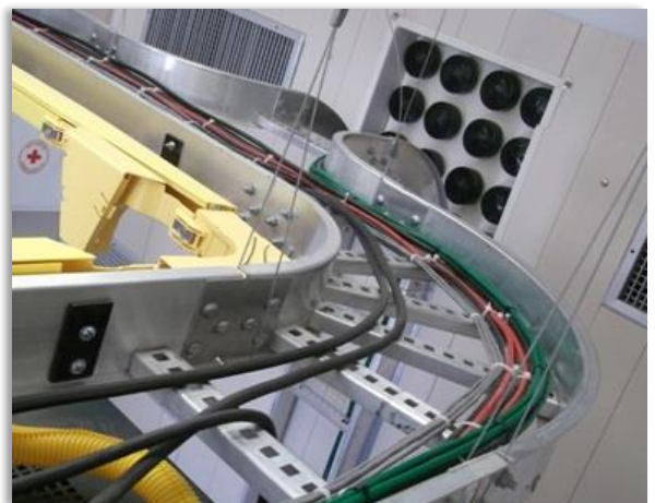
Escalerilla con curva de 90ª y bajada a paso de muros.
